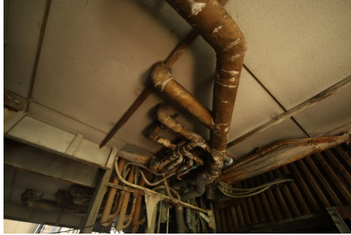
カプセルの底面に設置された配管。老朽化が進んでいた (写真: 安川 千秋) [画像のクリックで拡大表示]
